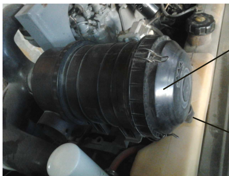
Figura 9: Filtro de ar do compressor e motor.
