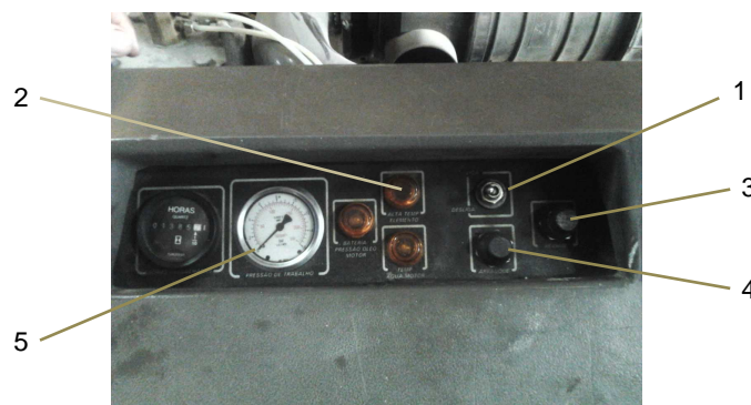
Figura 11: Painel de operação.
